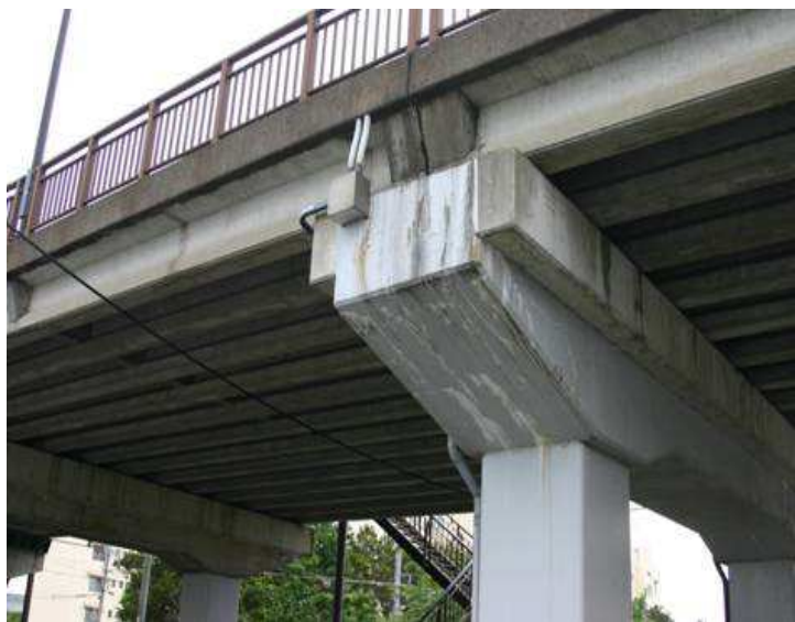
水分侵入抑制が困難 (伸縮装置部)
