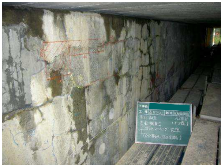
水分侵入抑制が困難 (橋台背面からの侵入)
